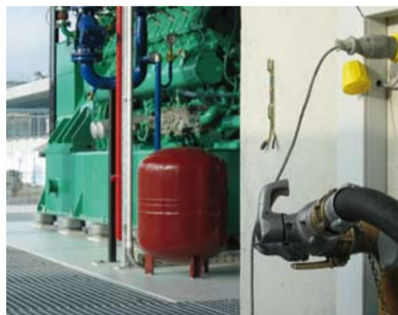
Der Öltank einer Grubengasanlage wird befüllt mit ADDINOL Gasmotorenöl MG 40-Extra LA
